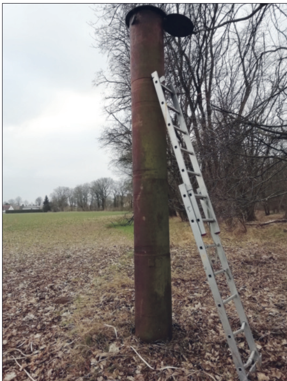
Abb. 3: Standrohr eines sog. Multifunktionsbrunnens (oder Mssstellenbündel), Standort: Schloßpark Schnaditz (hier im Rohr hat das gespannte Grundwasser aus dem GWL 4/5 eine Steighöhe von ca. 150cm!!). (Foto: R. Zenger)
