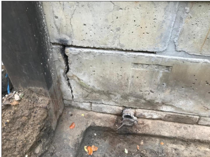
Abb. 3: Durch Vernässung entstandene Schäden am Mauerwerk und Fundament eines Produktionsofens der Köhlerei Eisenhammer (Foto R. Zenger)
