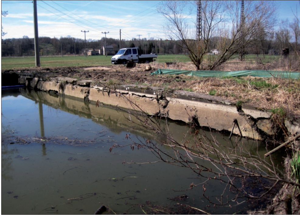
Abb. 54: Zustand der nördlichen Betonmauer, wie er sich nach der Wasserspiegelabsenkung darstellte (Foto: Mauritianum).
